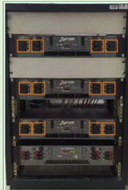
Imagen 64. Dimmer de luces.
