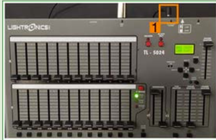
Imagen 65. Consola de luces estado inicial.
